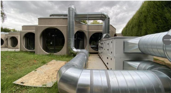
La Rûche est dotée de deux centrales de ventilation double-flux et de pompes à chaleur qui donnent à l'ensemble un aspect futuriste.
